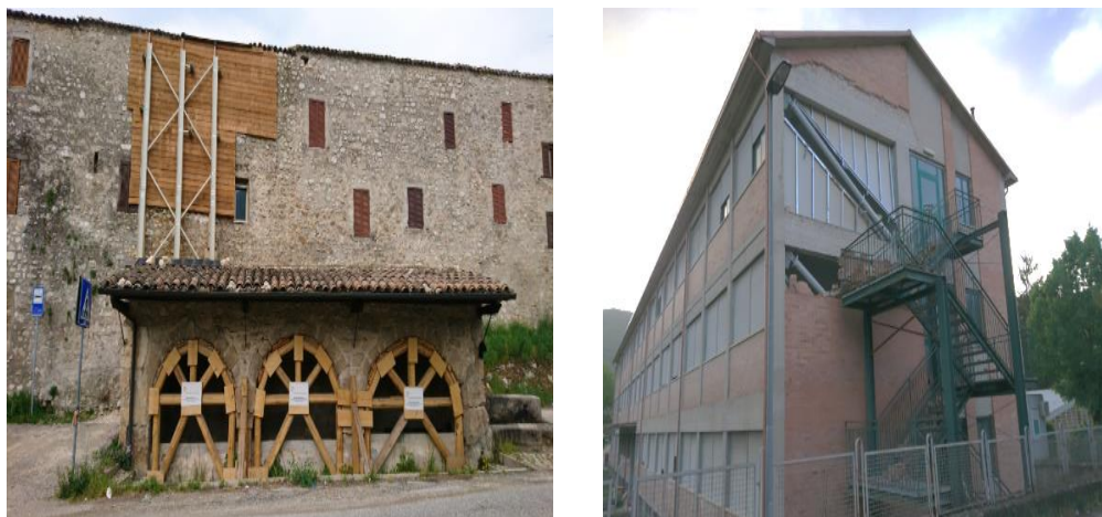
Figura 9. (a) Punerea în siguranță a zidului de incintă precum și a arcadelor de la construcția adiacentă/ (b) Punere în siguranță și contravântuiri la o școală existentă în Norcia Sursă: © Stefania Trifan, 2018
